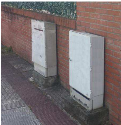
Figura 15: Ejemplo de armario a la intemperie
