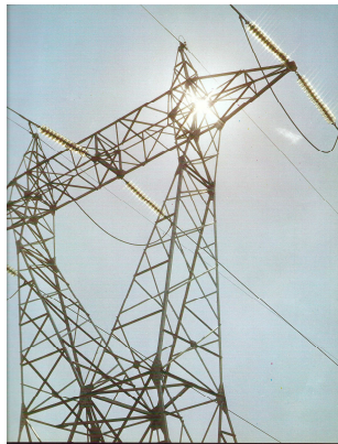
Figura 5.2: Aplicación en un tendido eléctrico
