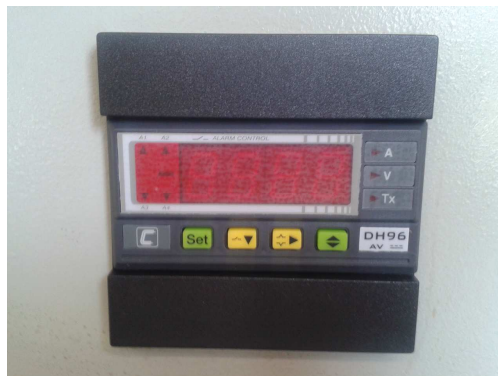
Figura 8.4: Nuevo medidor adaptado al equipo
