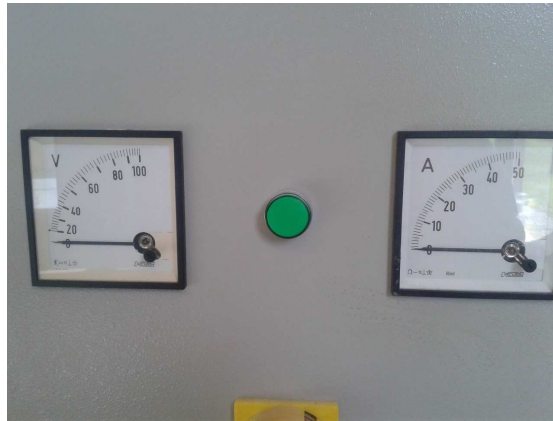
Figura 8.3: Medidores incorporados al rectificador
