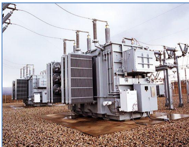
Ilustración 7. Trafo de subestación. Fuente: INGATEAM.
