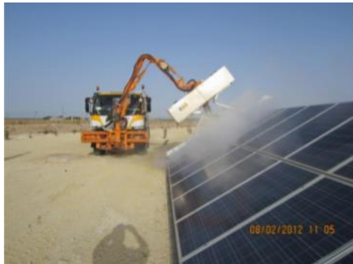
Figura 56. Limpieza de módulos mediante vapor desde tractor
