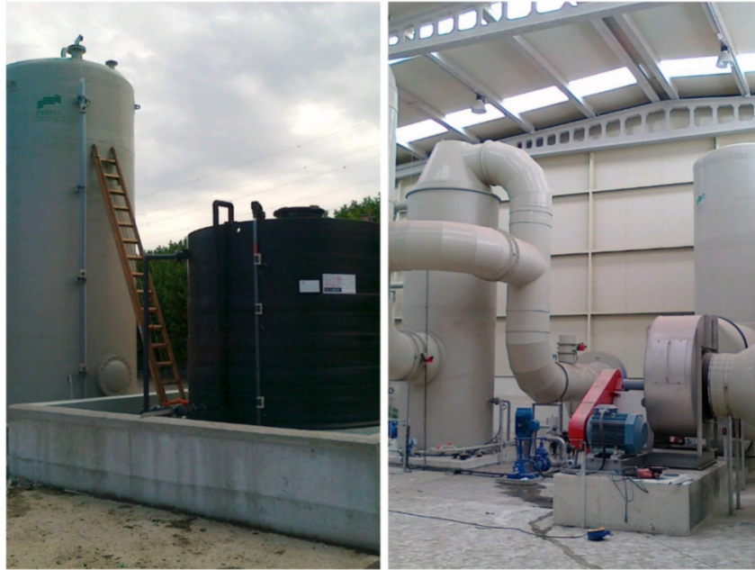
Figura 14: Deposito ácido sulfúrico. Deposito Scrubber. (Planta de compostaje de lodos de Arazuri. RETEMA)
