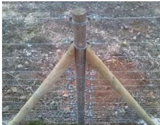
Figura 4: Poste de tensión y de refuerzo (Vinuesa vallas y cercados, 2013).
