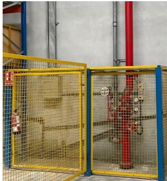
Ilustración 108. Zona antiincendios del almacén de productos terminados
