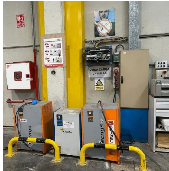
Ilustración 107. Grupo de baterías para cargar las carretillas
