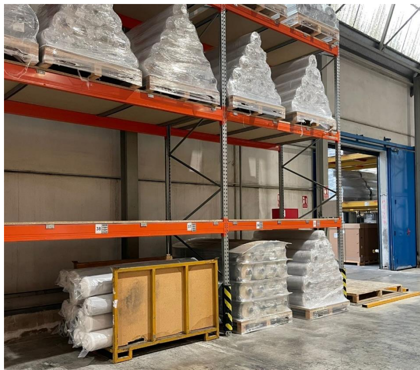
Ilustración 94. Vista de la calle B. Mercancía sin ubicación a ras del suelo
