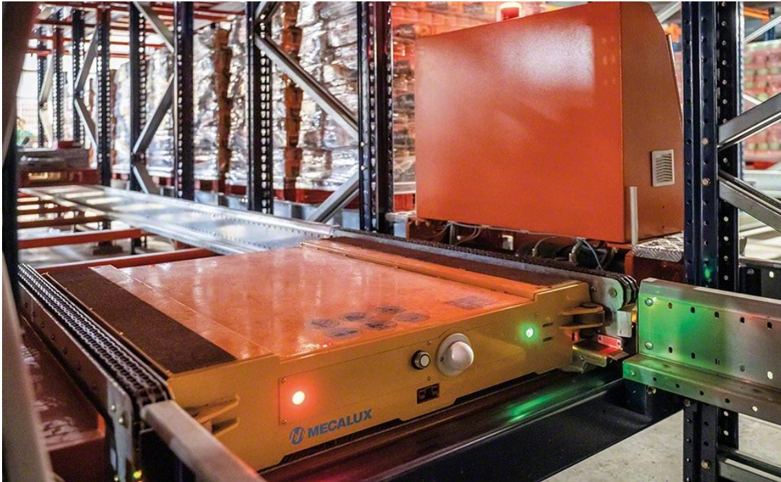
Ilustración 62. Estanterías con carruseles. https://www.mecalux.pe/casos-practicos/cister-almacen-legumbres-conserva-portugal
