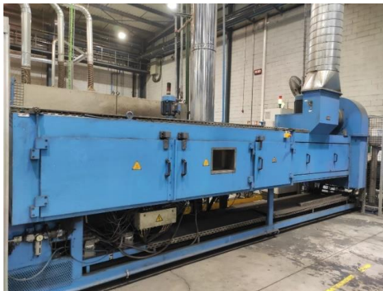
Ilustración 24. Escorchadora. Fuente: Elaboración propia
