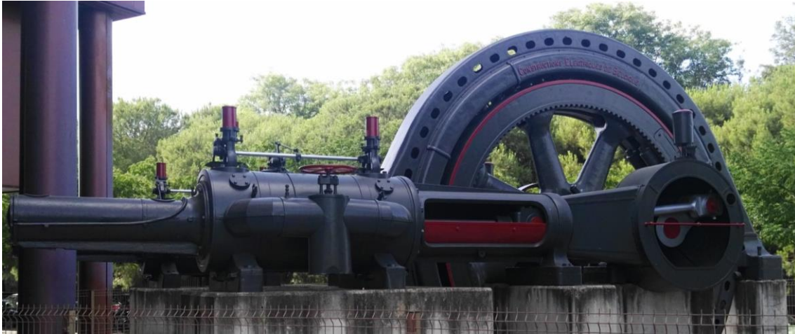
Figura 35: Generador eléctrico a vapor [38] .
