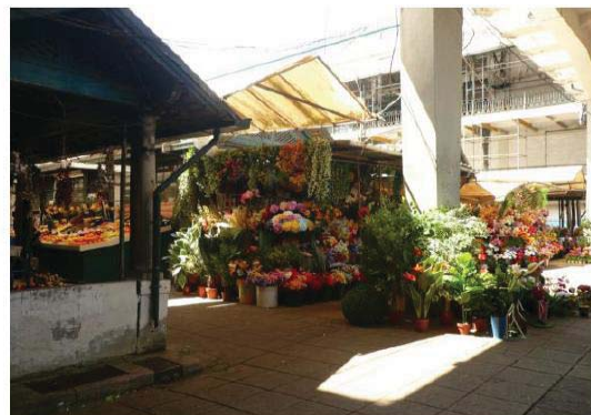
Se observa el degradado estado de las instalaciones.
