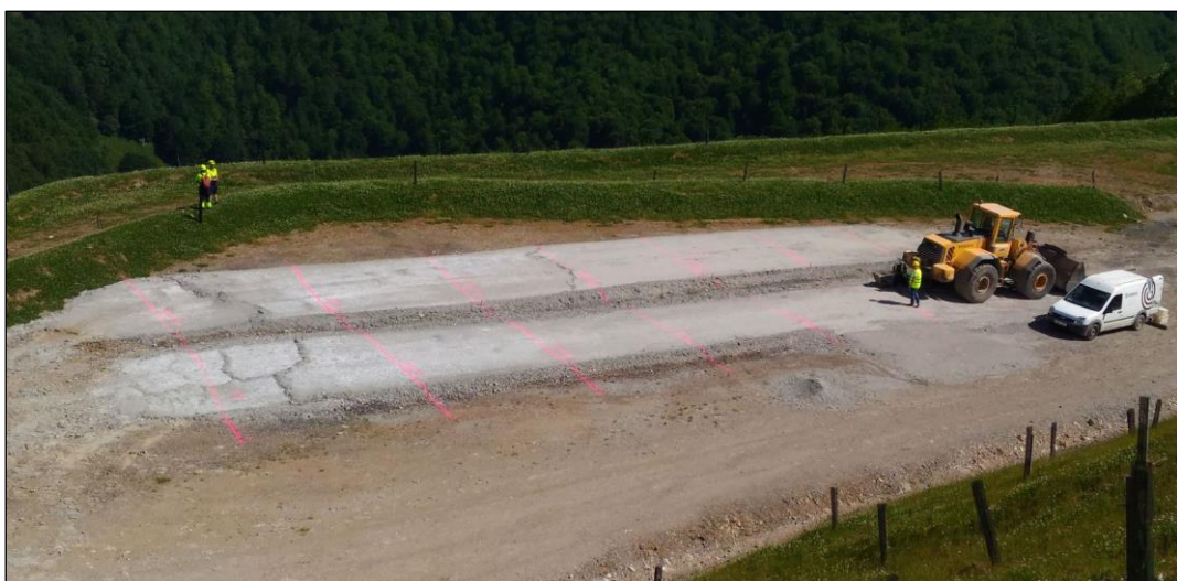
Fotografía 6. Imagen de la zona de pruebas de campo tras 40 días desde su estabilización
