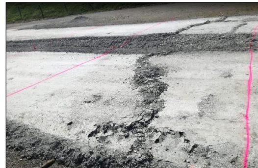
Fotografía 9. Zona CEM-I-SR con signos evidentes de hinchamiento
